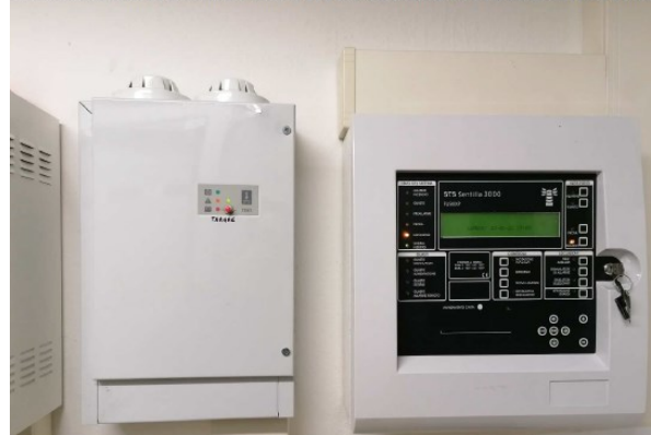
Centrale Rivelazione Incendi MARCA STS mod. Sentinella 3000 zona Locale Tecnico
