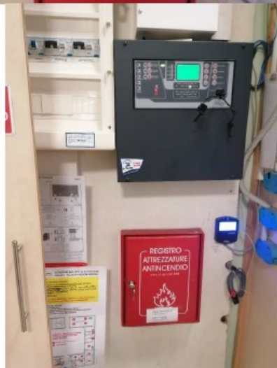
Centrale antincendio Ingresso El.Mo. Tacora
